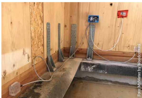
Sensori collegati a sonde di umidità e temperatura
