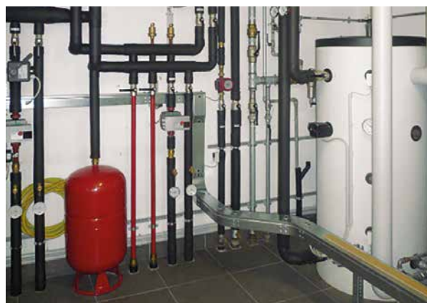
Locale tecnico con tubazioni isolate
