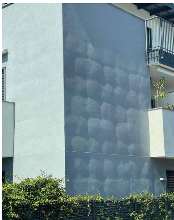
Rigonfiamento di un isolamento a cappotto mal realizzato
