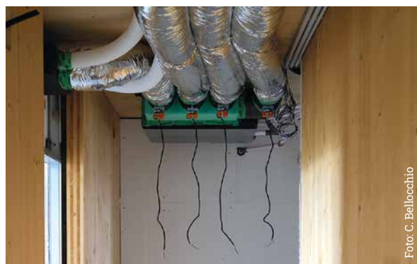
Canalizzazioni interne dell'impianto ad aria
