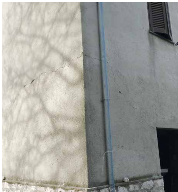
Apertura di fessure sullo spigolo del fabbricato a causa di un cedimento della fondazione
