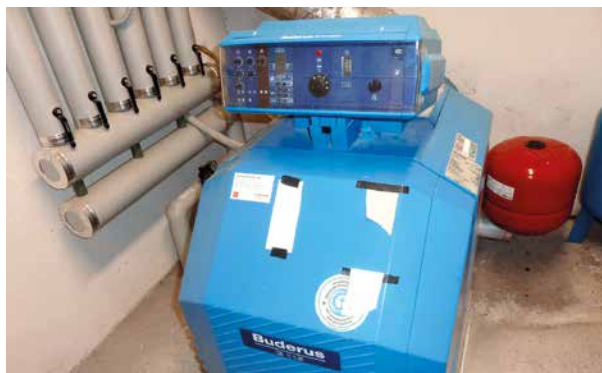
Vecchia caldaia a gasolio
