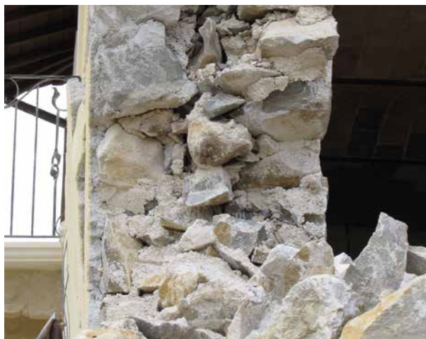
Muratura in pietra con legante di scarsa qualità che, sotto l'effetto dei carichi sismici tende a sgretolarsi
