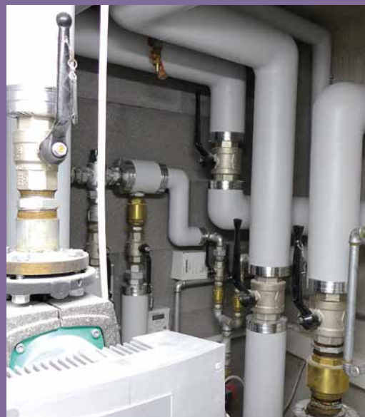
Rete termica con tubazioni coibentate
