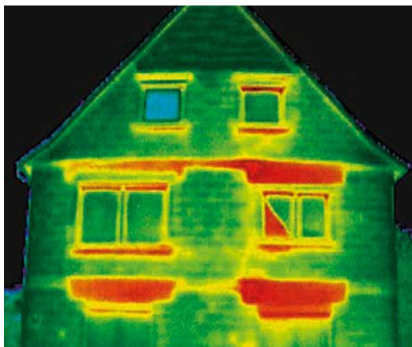
Dispersioni termiche in corrispondenza del cassonetto
