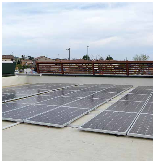
Pannelli fotovoltaici inseriti nel sistema tetto cool roof, altamente riflettente, che permette la riduzione della temperatura superficiale della copertura e la diminuzione dell'effetto isola di calore.
