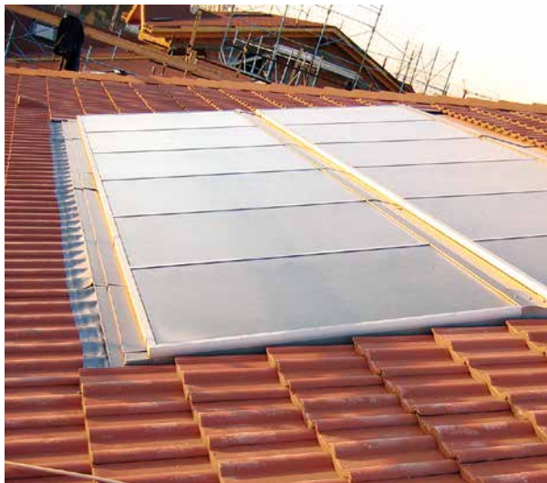
Collettori piani integrati in copertura
