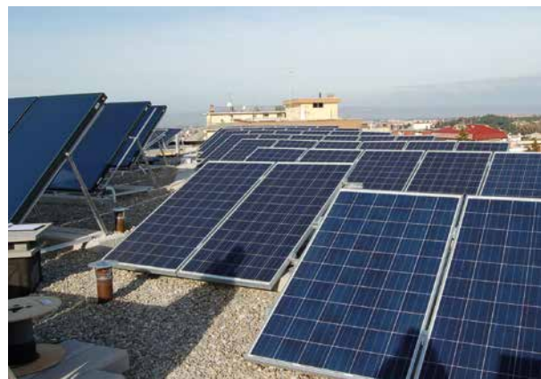
Copertura a tetto piano con pannelli in silicio monocristallino
