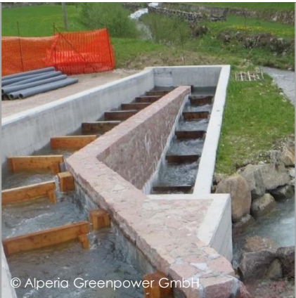
Fischtreppen und Maßnahmen zur Fischpassierbarkeit
