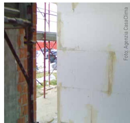
Errori nell'installazione dei pannelli
