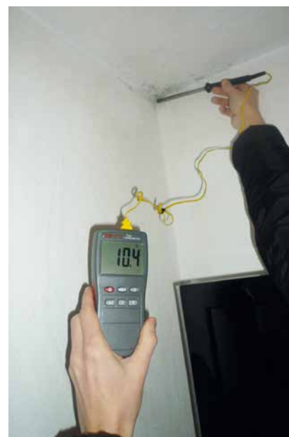
Verifica della temperatura con termometro per contatto in un ponte termico d'angolo in un edificio ad Aica (BZ)
