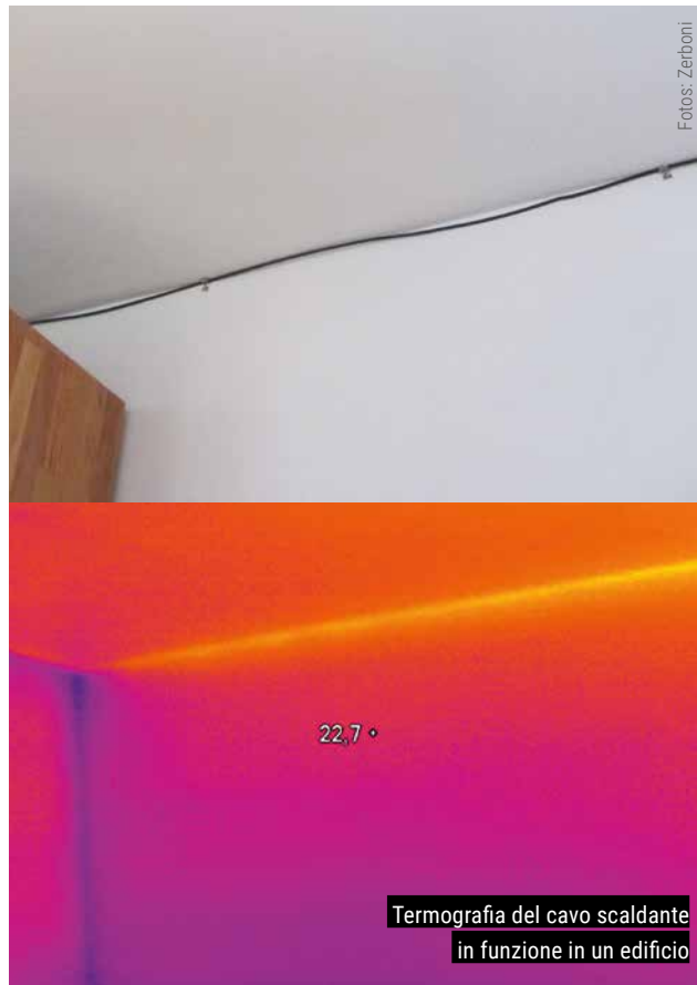
Dettaglio dell'installazione del cavo scaldante nell'edificio
